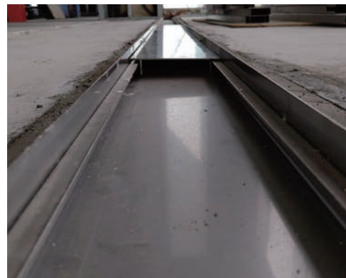
電気配線用SUS側溝
